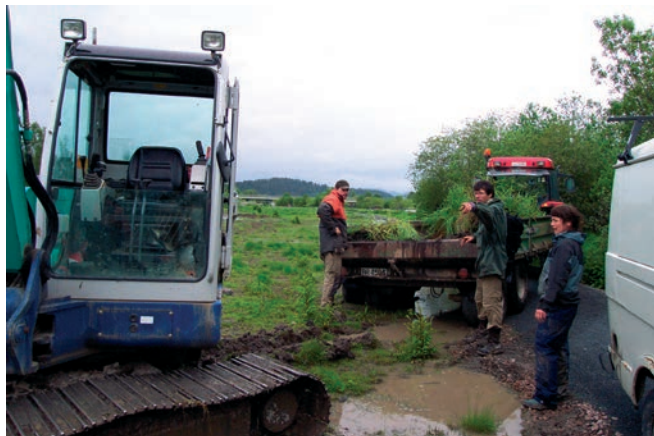
Et lass med planter er hentet fra Langemosen. Bård Bredesen, Friluftsetaten, anviser hvor plantene skal plasseres.
