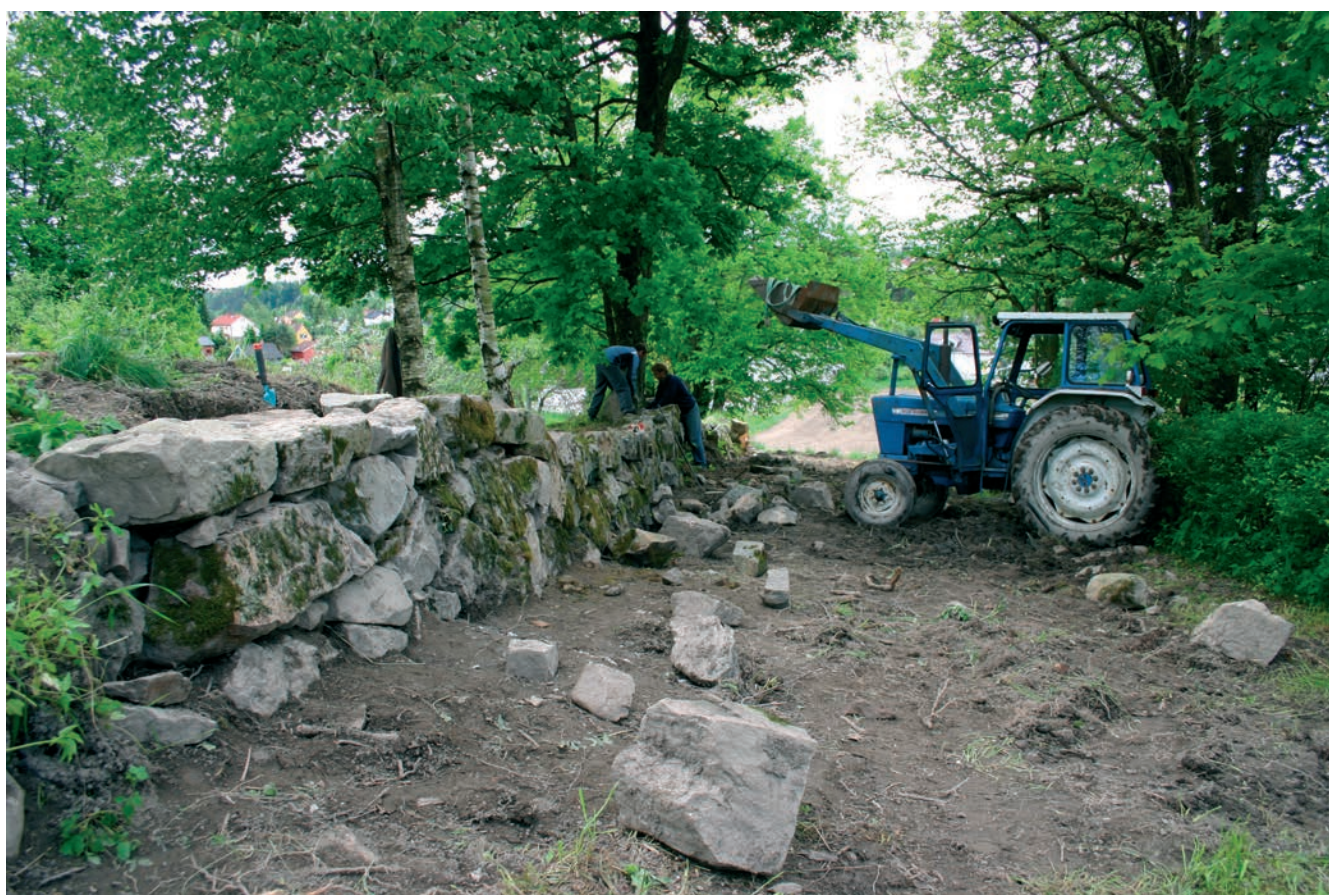
Rehabiliteringsarbeidet er i gang med Asgeir Føyen på Abildsø gård som tørrmurbygger.
