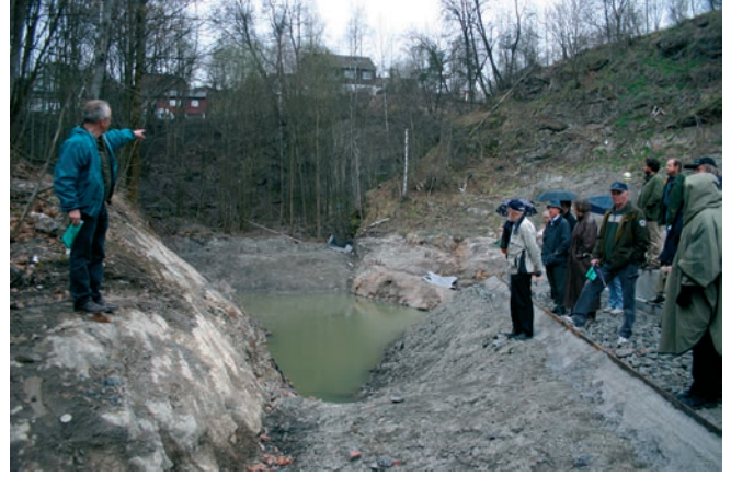
Vannparken på Hølaløkka, litt nord for Grorud stasjon, under arbeid i april 2004. Dette er det første virkelig store gjenåpningsprosjektet i elvas historie. I september samme år ble vannparken offisielt åpnet.
