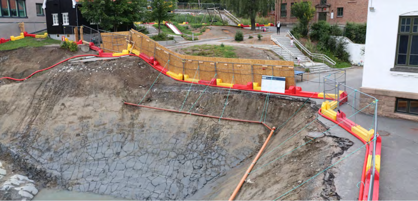
Den marine leire ligger tett opp mot skolebygningen som ble påbegynt oppført i 1917, men som gled ut på grunn av leire og først ble åpnet i 1918. Foto: 04.08.2019.
