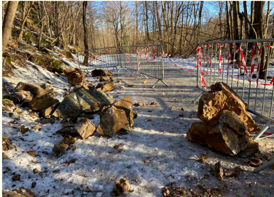
Rasstedet ved turveien ble raskt sperret.
