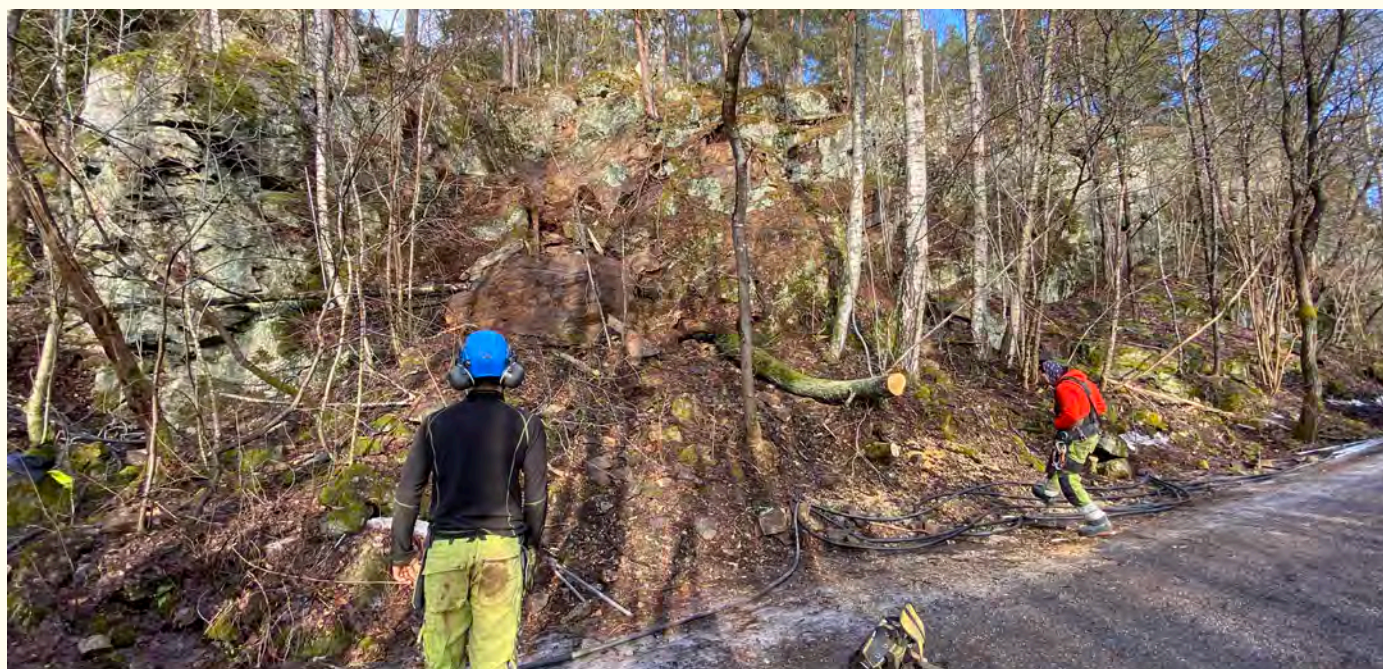
To mann fra Fjerby Fjellsikring AS ser mot stedet der raset gikk.
