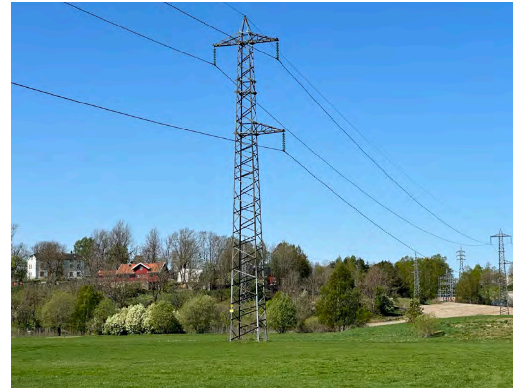
Mastene leder inn til trafoen i Plogveien. Foto: Leif-Dan Birkemoe, 12.11.2022.
