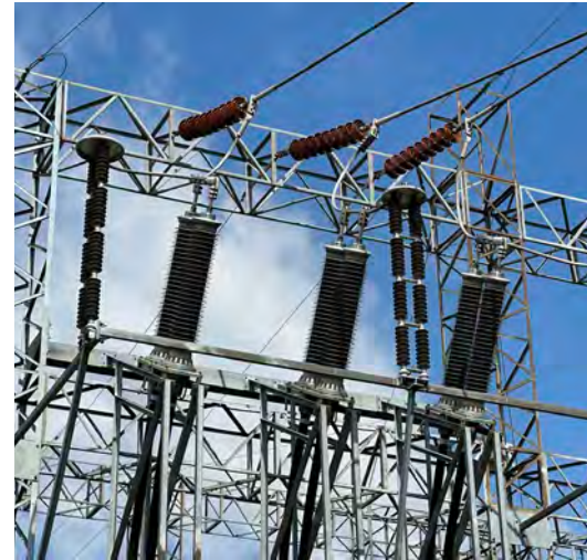
Trafoen i Plogveien har markante isolatorer. Foto: Leif-Dan Birkemoe, 12.05.2023.
